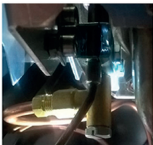
Die Position des Kontrollbrenners
